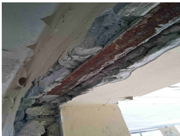
Foto. 13 Nadproże drzwiowe w ścianie wewnętrznej
