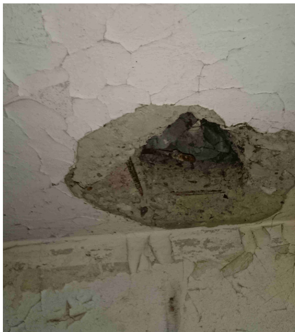
Foto. 36 Odkrywa płyty spocznikowej – widok od spodu
