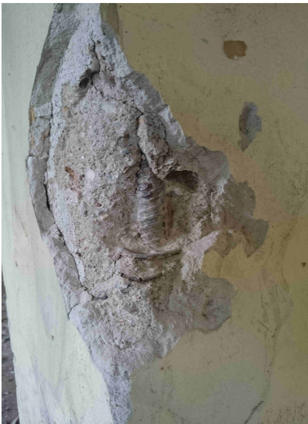
Foto. 55 Odkrywka zbrojenia słupa parteru
