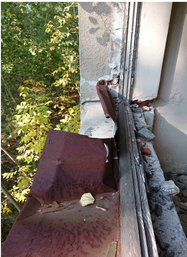
Foto. 19 Obróbka blacharska parapetu
