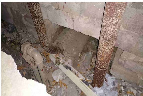
Foto. 34 Przyłącze c.o. w budynku
